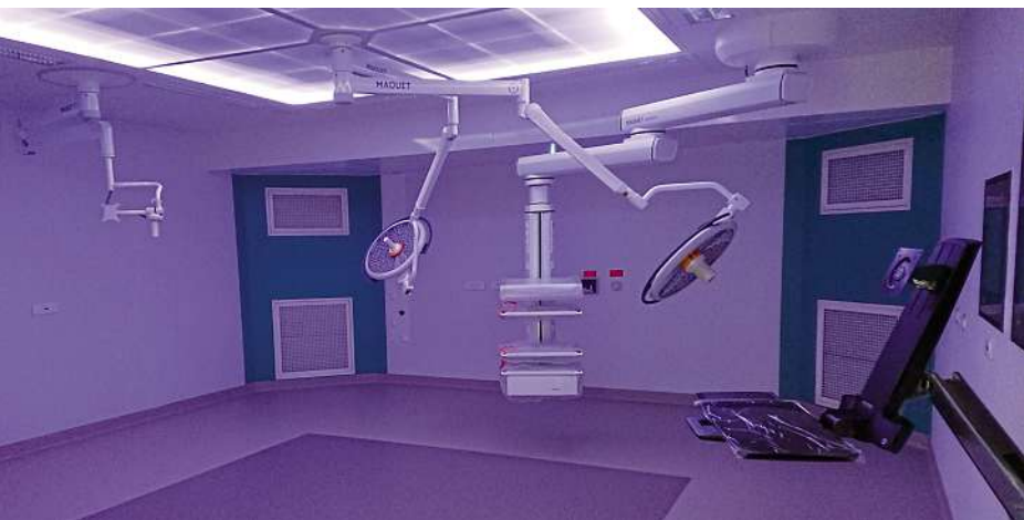
Centrale de traitement d'air en «mode normal» avec un bandeau LED et un éclairage à la lumière du jour
