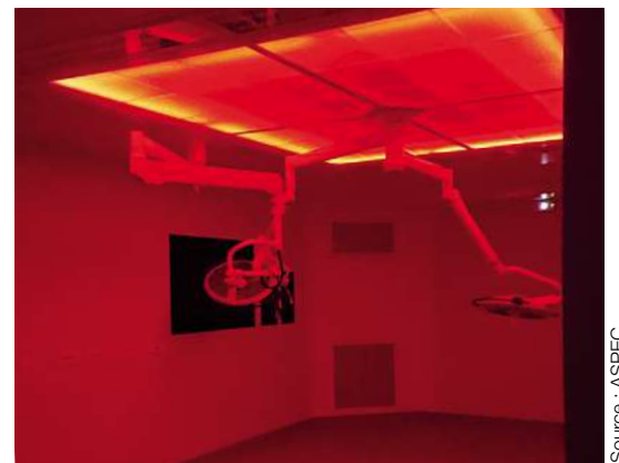
Centrale de traitement d'air en «mode veille» avec un bandeau LED et une bascule en rouge.
