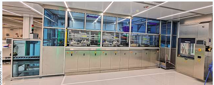
Installations de lavage immersion US et aspersion avec liaison salle grise/salle blanche
